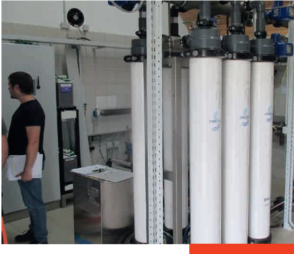
li: In Kupferzell wurde ein neues Wasserwerk gebaut. re: Bodenverwertung bei Bitzfeld
