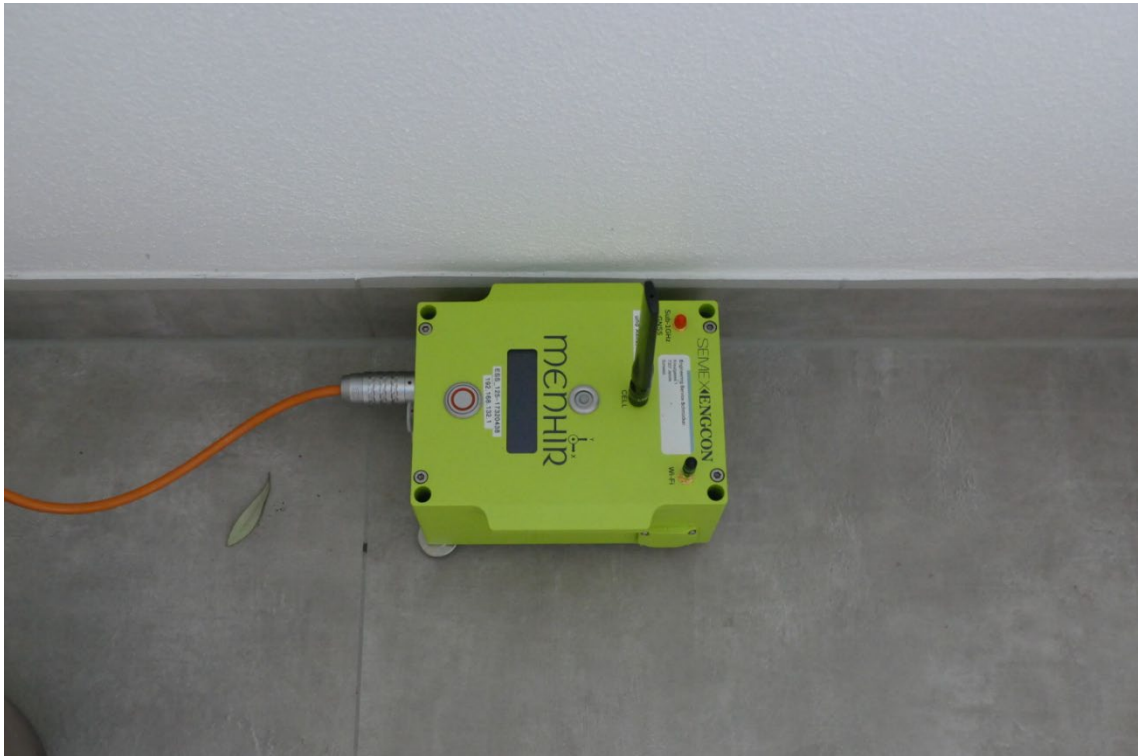
Detailansicht Fundamentmessstelle IO 01 a
