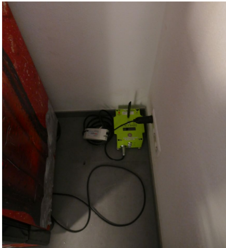
Detailansicht zum Fundamentmessort IO 02 a
