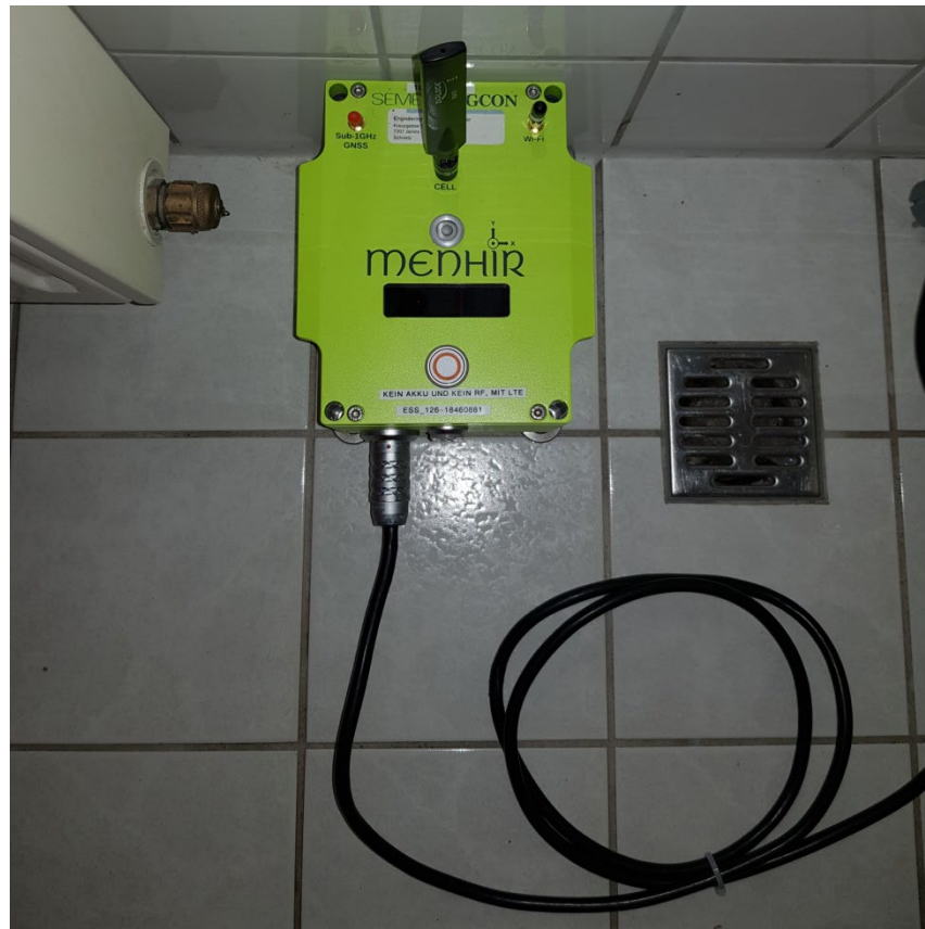
Detailansicht zum Fundamentmessort IO 03 a
