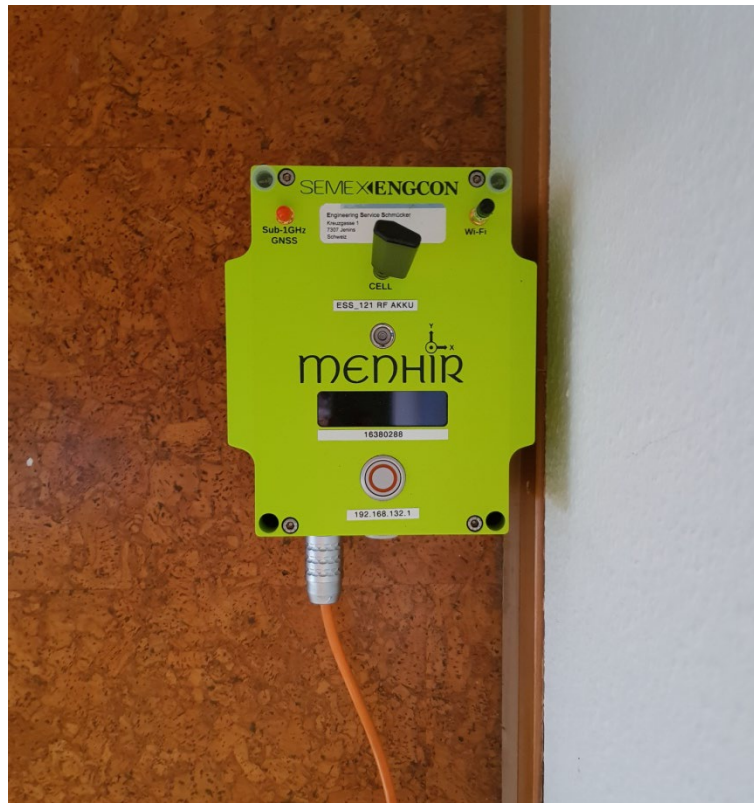
Detailansicht zum Messort OG aufsteigendes Mauerwerk IO 03 b
